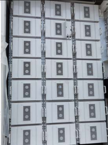
集装箱打开看到内部照片（背面）
